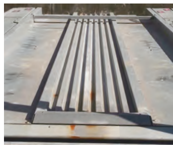
塗装前の様子 亜鉛めっきされているが所々にさびが発生
