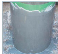
照明柱の延命化
